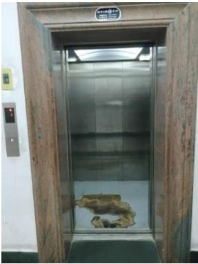
圖 15 綜合樓 B 棟轎廂
