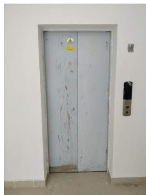
圖 7 新建藝術樓電梯候梯廳
