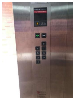
圖 10 第四教學樓電梯選層按鈕
